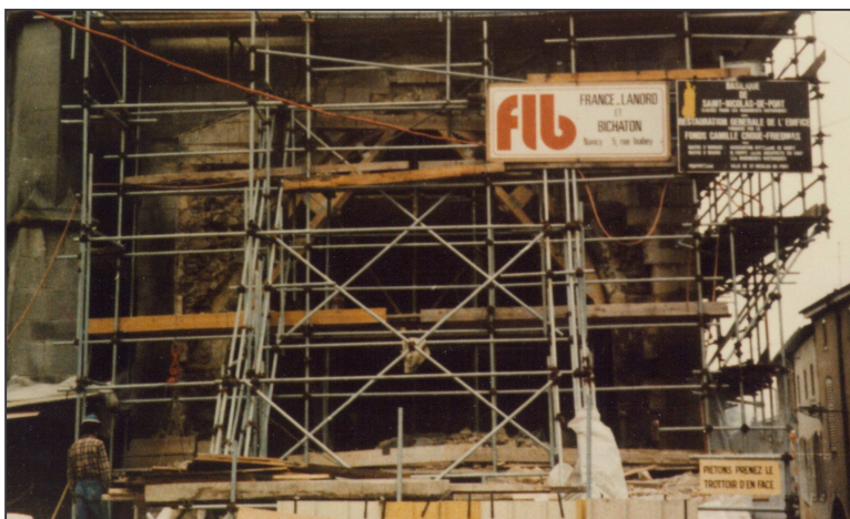
La façade sud de la sacristie étayée.
